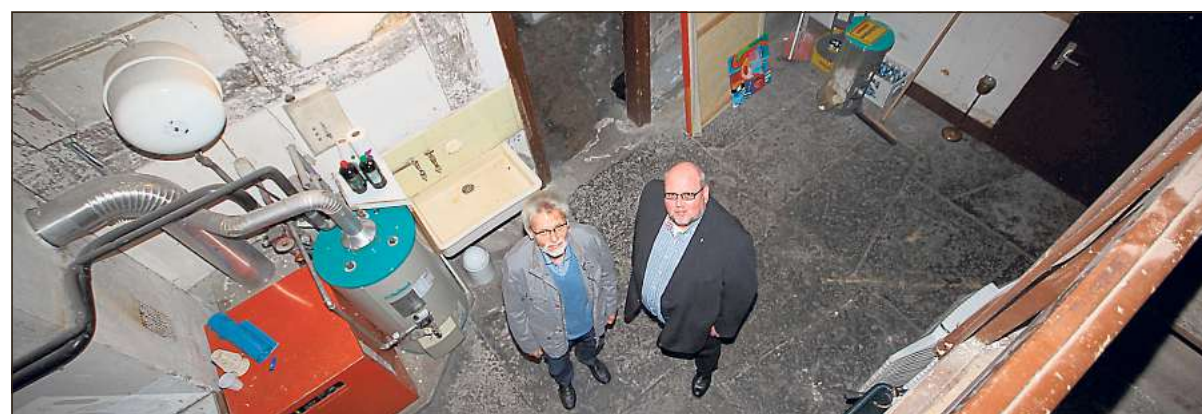
Zukunftsmusik: Die Deele im Fachwerktrakt aus dem Jahr 1658 eignet sich ideal für Konzerte und andere Kulturveranstaltungen, sind sich Hermann Josef Budde und Ludger Vollenkemper (v. l.) einig. Im Zuge der anstehenden Umbauarbeiten soll dieser Bereich des ehemaligen Küsterhauses vergrößert werden.
