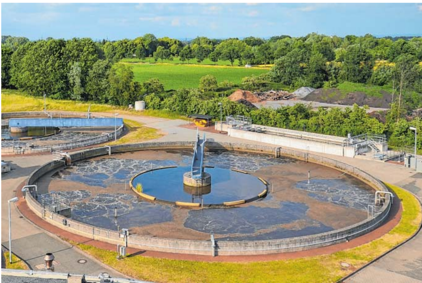
Handlungsbedarf: In letzter Zeit kam es vermehrt zu Ausfällen einzelner Gebläse, die der Belüftung der Belebungsbecken dienen und somit von höchster Wichtigkeit für die Anlagensicherheit sind.
