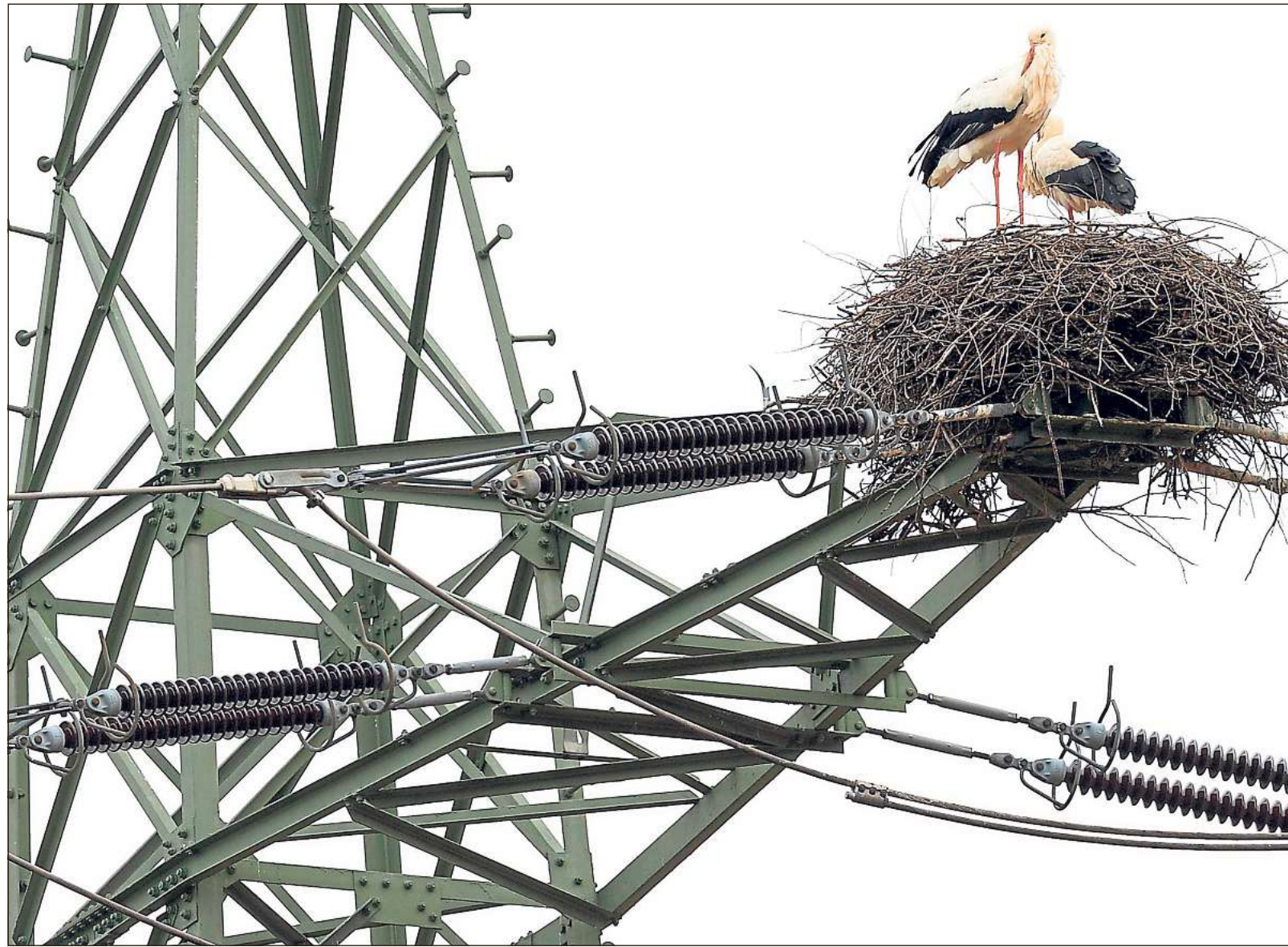
Die Hinterlassenschaften von Störchen – und nicht wie auf diesem Archivbild ihre Nester – haben gleich zweimal einen Feuerball an einem Hochspannungsmasten an der Straße „Am Jägerheim“ zwischen Lintel und Wiedenbrück verursacht. Bild: dpa
