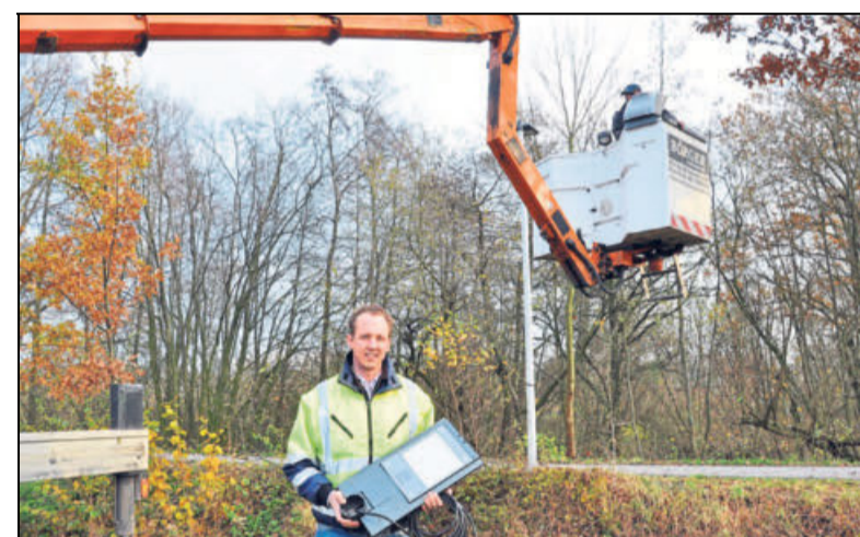
Karsten Knöbel (vorne) und Heinz Blankert (im Hubsteiger) von der Firma Börger Elektrotechnik haben insgesamt zwölf Laternenköpfe zwischen Hauptstraße und Am Werl installiert.
